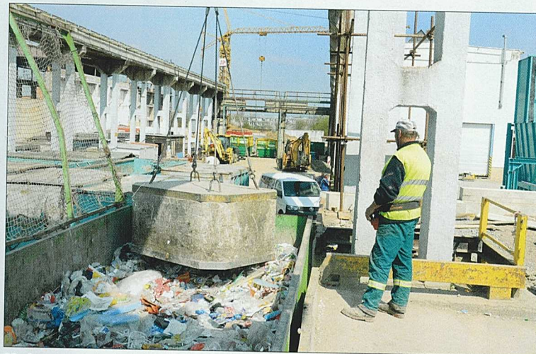
V olomoucké překládací stanici zatím využívají stacionární jeřábovou dráhu a odpad hutní v kontejnerech gravitačně pomocí 4t břemene. Tomu odzvoní koncem května, kdy závaží nahradí stacionární lis
